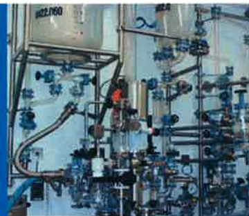
Reactor for high active pharmaceutical ingredients 高活性製薬原料向けプラント
